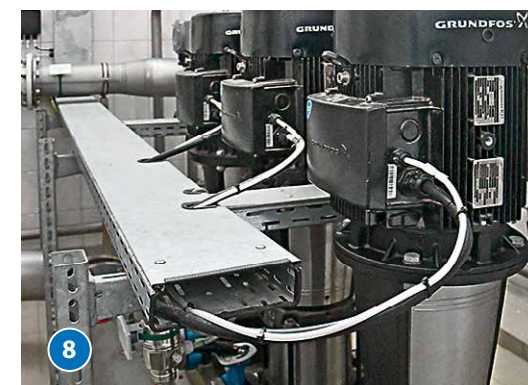
Die Netzförderpumpen transportieren das aufbereitete Trinkwasser aus den Reinwasserbehältern in das Leitungsnetz. Sie passen ihre Förderleistung automatisch an den aktuellen Bedarf an und sorgen für einen gleichbleibenden Druck in allen Versorgungsbereichen.
