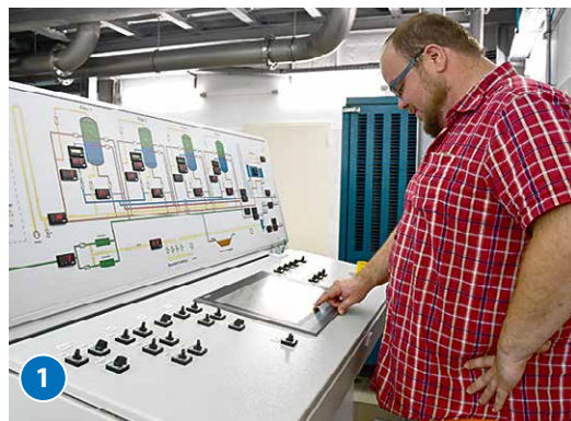
Alexander Becker an der Kontrollbank: Über die zentrale Steuerung überwacht und regelt er alle Prozesse im Wasserwerk – von der Brunnenförderung bis zur Wasserverteilung. Das geht natürlich auch über unser Leitsystem. Störungen und Verbrauchsspitzen lassen sich so jederzeit schnell erkennen.
