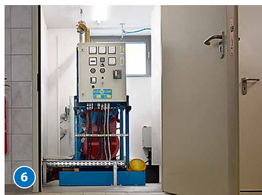
Das Notstromaggregat sichert bei Stromausfall den Weiterbetrieb aller zentralen Anlagen im Wasserwerk Hohendorf. So bleibt die Trinkwasserversorgung auch im Havariefall gewährleistet und der Betrieb läuft unterbrechungsfrei weiter. Ein doppelter Boden für durchgängige Wasserversorgung.
