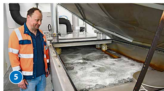
Die Entsäuerungsanlage – für den optimalen pH-Wert: Paul Wiese: Seit 2019 wird in der Entsäuerungsanlage durch das im Wasser gelöste CO 2 durch das Einblasen von Luft ausgetrieben. Der pH-Wert wird dabei stabil auf 7,5 angehoben, Korrosion in den Leitungen verhindert. Durch die Entsäuerung wird das Wasser stabiler und weniger anfällig für chemische Reaktionen, die zu unerwünschten Geschmacks- oder Geruchsbeeinträchtigungen führen können.
