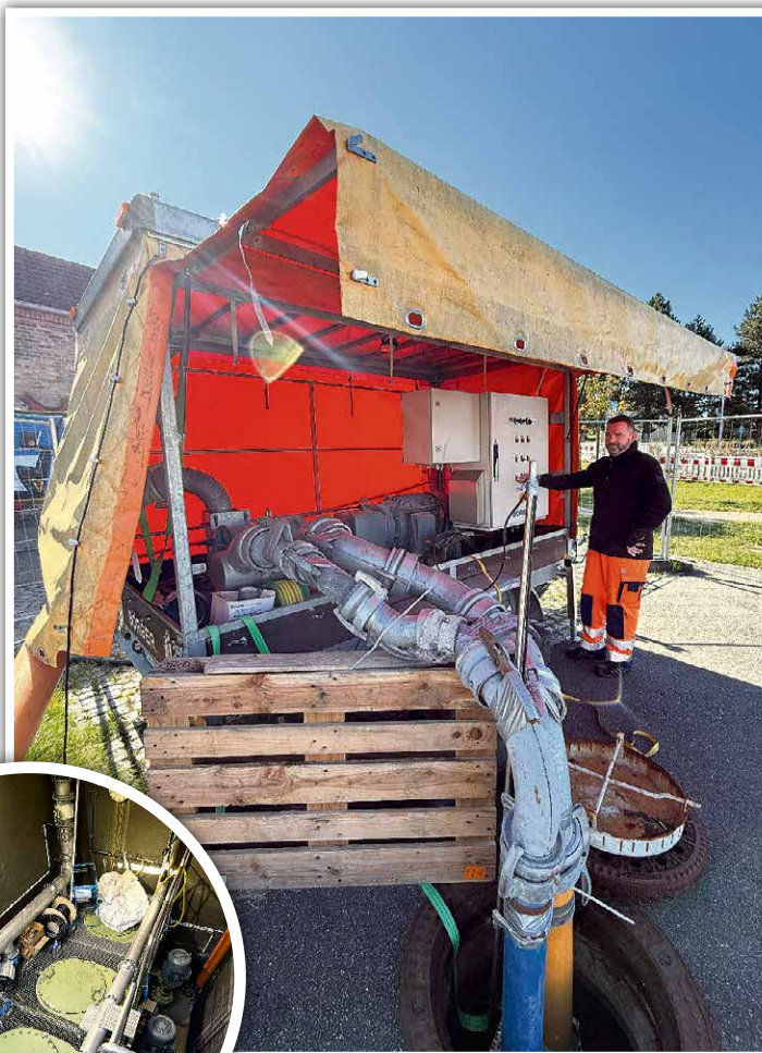
Eine mobile Pumpe transportierte das Abwasser zur Kläranlage Wolgast, bis die beschädigten Pumpen (Foto links) wieder arbeiteten.
