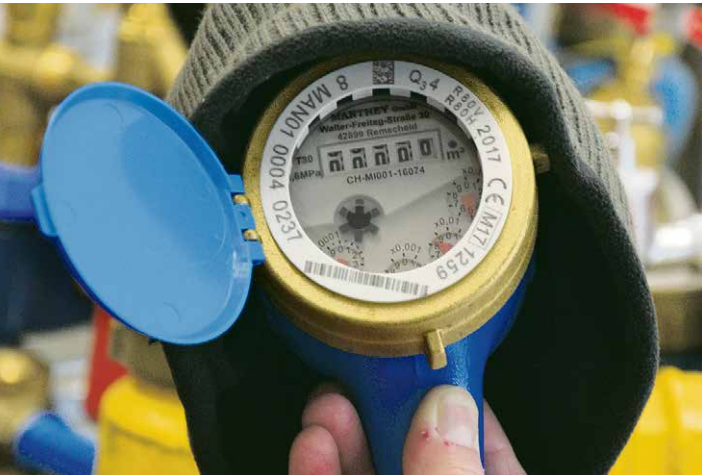
Wasserzähler müssen in Herbst und Winter warm eingepackt werden, um vor Kälte geschützt zu sein.
